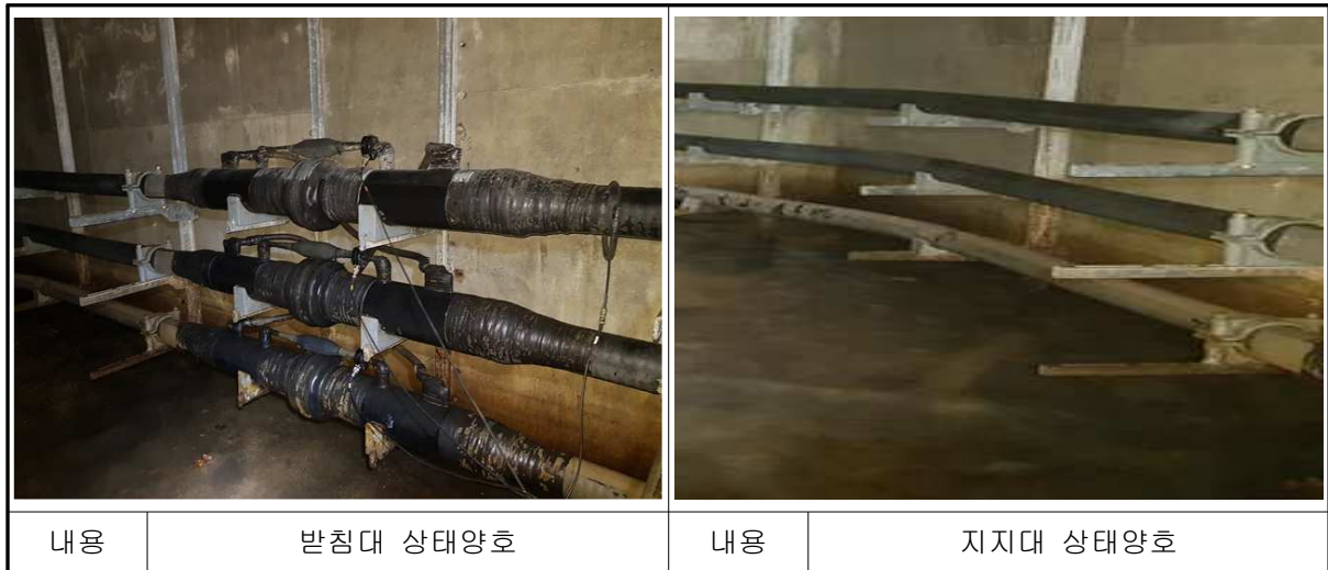
【사진 8.8】 부속 및 부대설비 현황
