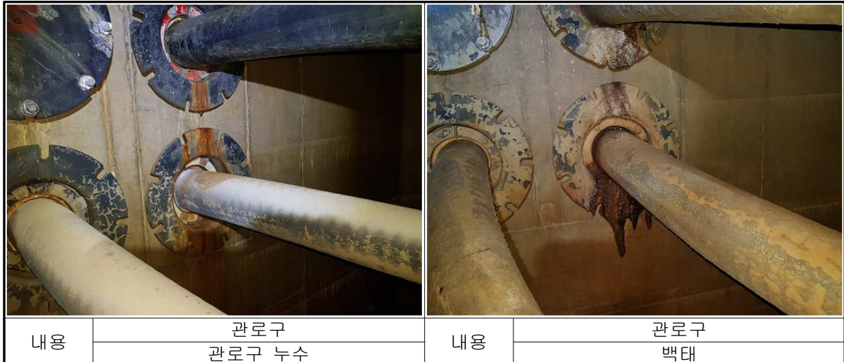
【사진 8.38】 맨홀 내부 주요 손상
