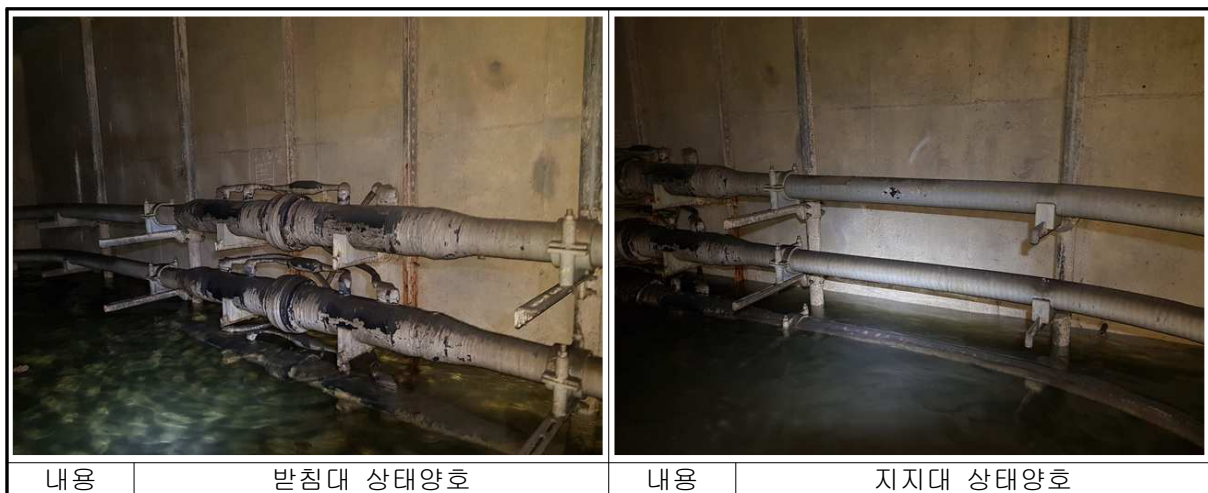
【사진 8.4】 부속 및 부대설비 현황
