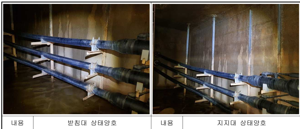
【사진 8.36】 부속 및 부대설비 현황
