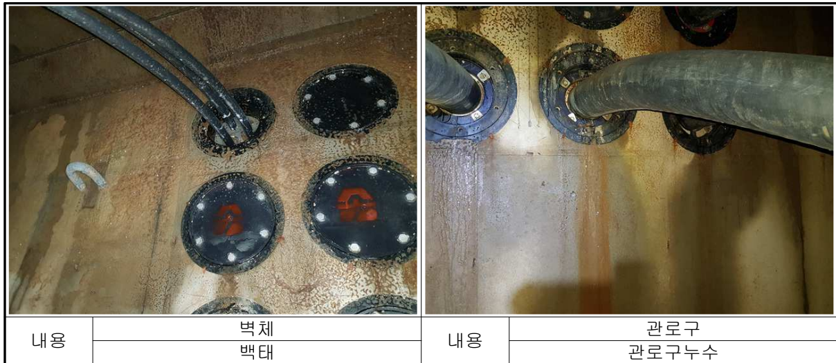
【사진 8.34】 맨홀 내부 주요 손상
