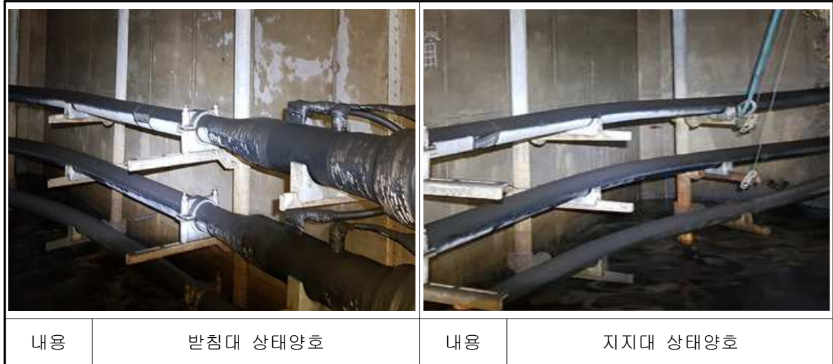
【사진 8.16】 부속 및 부대설비 현황
