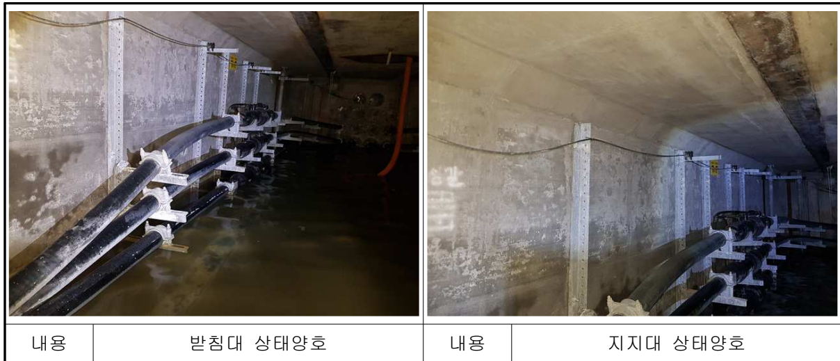
【사진 8.32】 부속 및 부대설비 현황
